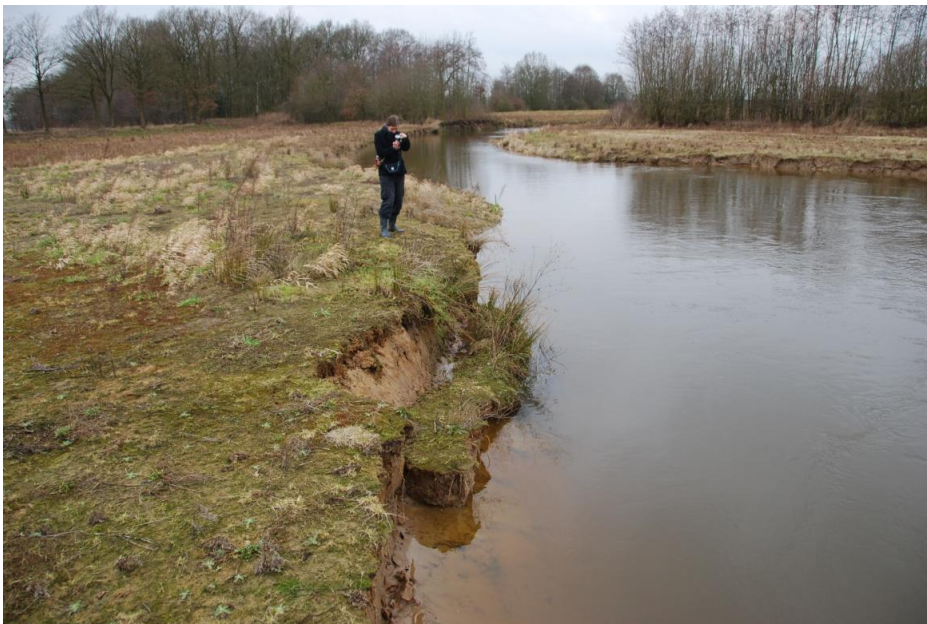
Figuur 4.3 – Ingestorte oever. Het materiaal beschermt de oeverteen tegen verdere erosie (Wytema, 2009).
